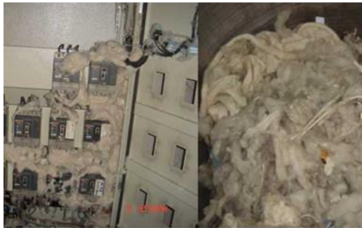
řekil 12. İçi hav kaplamıř elektrik panosu ve geliřigüzel atılmıř sigara izmaritleri.
